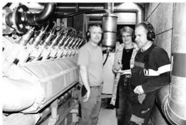
Foran gasgeneratoren, som larmer rigtig meget
